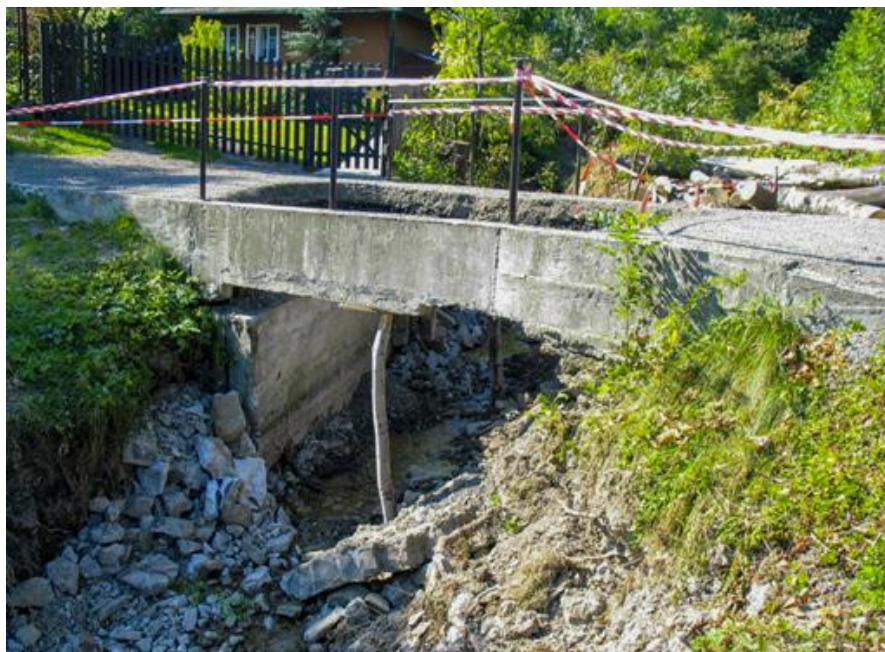
Fot. 142. Straty powodziowe w 2005 roku – uszkodzony mostek o zbyt małym świetle, Targaniczanka (fot. L. Książek)
